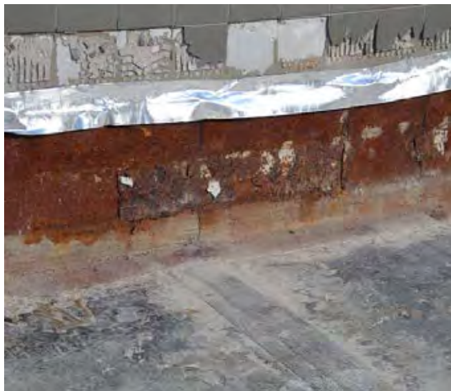
Obr. č. 10 – Svislá část hydroizolace (krytá provizorní asfaltovou samolepící páskou) po odstranění mechanického kotvení a mechanické ochrany hydroizolace
