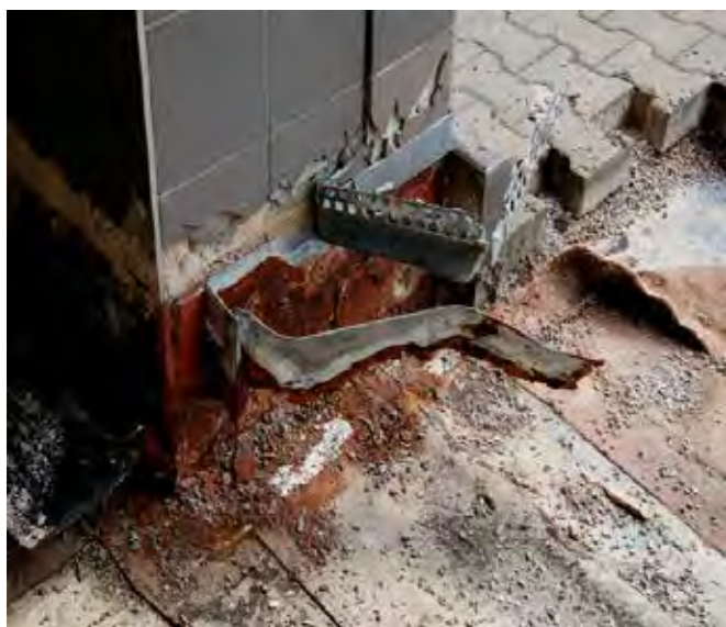
Obr. č. 9 – Detailní pohled na zkorodovanou část mechanické ochrany hydroizolačního souvrství
