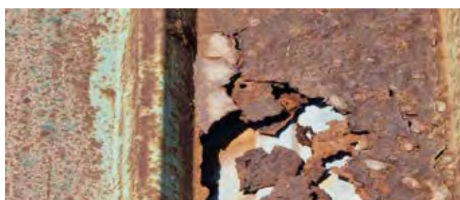
Obr. č. 7 – Totální destrukce kovového materiálu tvořící střešní plášť
