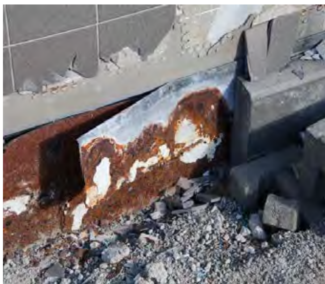
Obr. č. 11 – Koroze ochranných klempířských prvků
