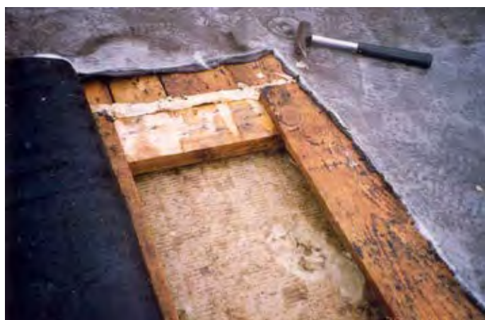
Obr. 2: Horní dřevěný záklop jednoplášťové ploché střechy s izolací pouze mezi nosnými dřevěnými prvky, poškozená z důvodu vysokého výskytu kondenzátu pod svrchní hydroizolační vrstvou.
