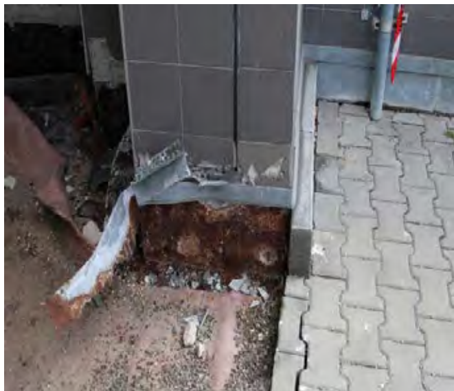
Obr. č. 8 – Původní řešení je vpravo, vlevo je z části již vybourané souvrství provozního střešního pláště, kde je patrné zatažení ochranných kovových vrstev pod úroveň provozních vrstev
