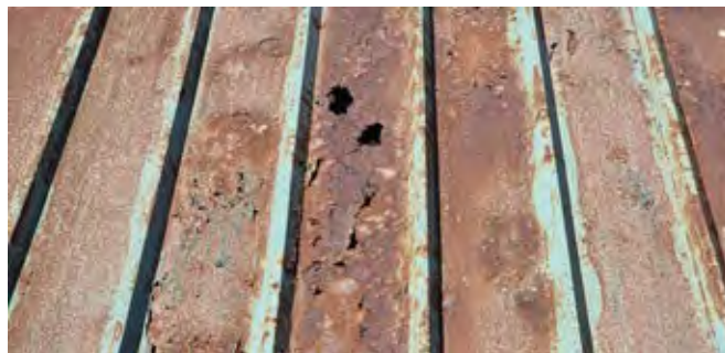
Obr. č. 4 – Všechny stupně koroze plechů
