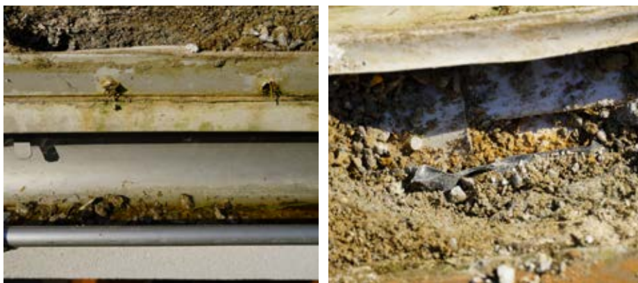
Obr. 5 Ľudová tvorba alebo slovesnosť – vítačkou na stavbe vyrobená odvodňovacia lišta z drenáže, z ktorej žiadna voda nevytečie a napojenie nopovej fólie na túto lištu...
