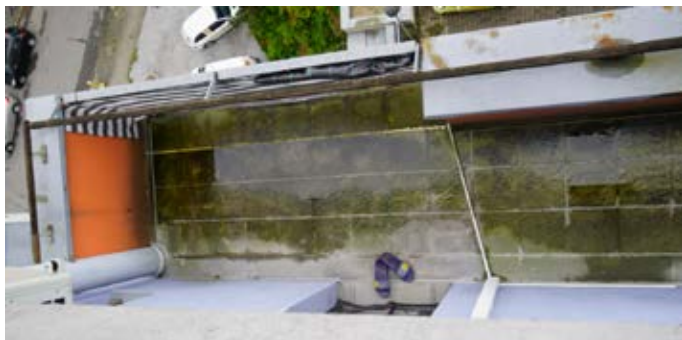
Obr. 4 Šípkou je označený zlom medzi radmi dlažieb kde sa kumuluje voda a nemôže voľne odtekať. Severná orientácia tohto balkónu podporuje spolu so zlým odvodnením tvorbu šmykľavých rias. Zhnité drevené madlo, kotvené skrutkami cez oplechovanie ani nespomínam.
