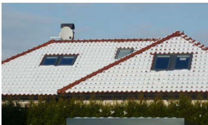
Obr. 2: Sneh, ktorý sa drží na celej ploche strechy je najlepší indikátor správnej funkčnosti izolácií. Tepelný izolant je tu chránený pred vlhkosťou z interiéru správne zvolenou a nainštalovanou parozábranou – nevytvárajú sa tepelné mosty.
