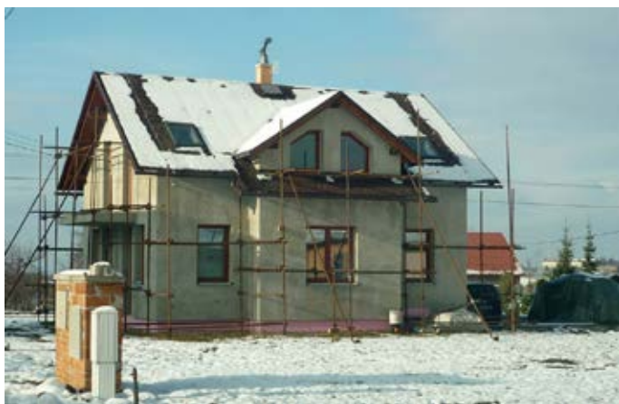
Obr. 1: Roztopený sneh - typický znak zle zrealizovaného napojenia parozábrany na štítové murivo. V tomto mieste vodná para kondenzuje na vodu a vznikajú tepelné mosty, ktoré poškodzujú celú konštrukciu.
