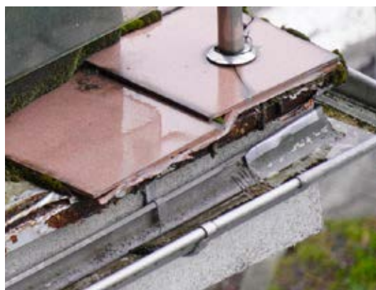
Obr. 3 Pokročilé štádium vzniku vegetačného balkónu, kde spod dlažby vyrastá tráva a vpravo degradácia, kde len trvalo pružný tmel bráni pádu dlažby na chodník pred budovou
