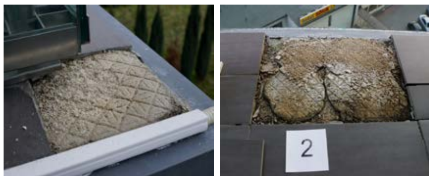
Obr. 2 Dlažba odobratá voľnou rukou pri odkvape balkónu ukazuje na vymyté lepidlo a pôvodne lepšie alebo horšie prilepenú dlažbu
