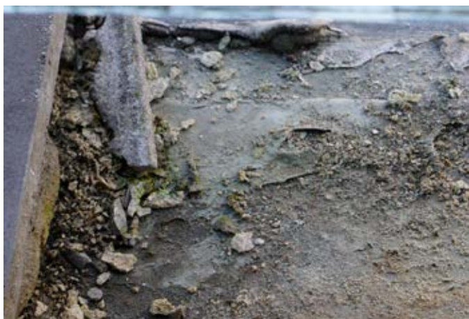
Obr. 6 Zvyšky náterovej hydroizolácie po pozametaní flexibilného lepidla
